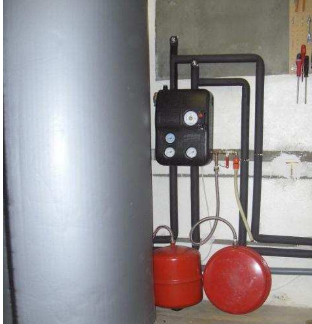
Le stock combiné, la station solaire et les lignes solaires
