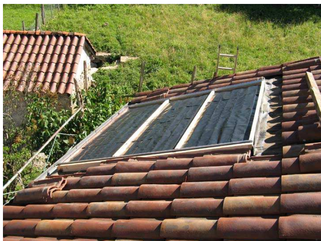
Les absorbeurs sont en place.
