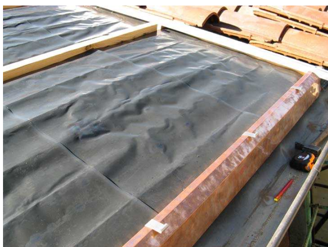
La zinguerie cuivre sur la traverse bas : simplifiée vu le montage en bordure du toit
