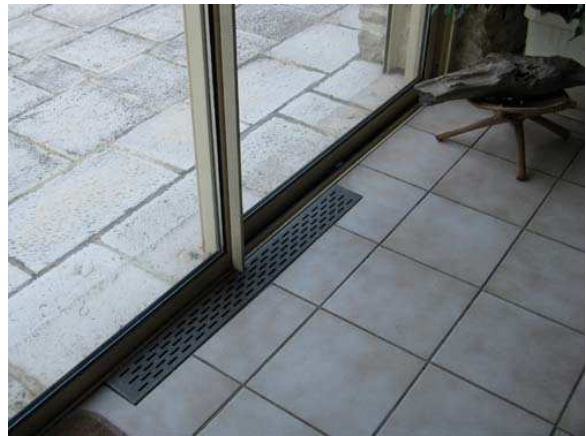
et les bouches d'air vers les baies vitrées
