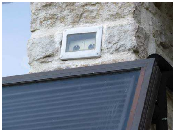
Le boîtier des thermostats de commande des volets roulants
