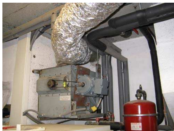
Le ventilateur du foyer à bois
