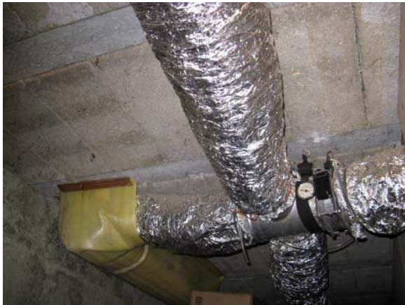
Les conduits d'air chaud sous la dalle,
