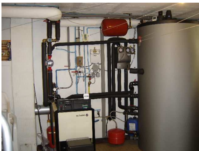
Ballon, chaudière, tuyauterie, etc...
