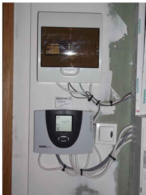
Régulation Vision et contacteur de la vanne 3 voies
