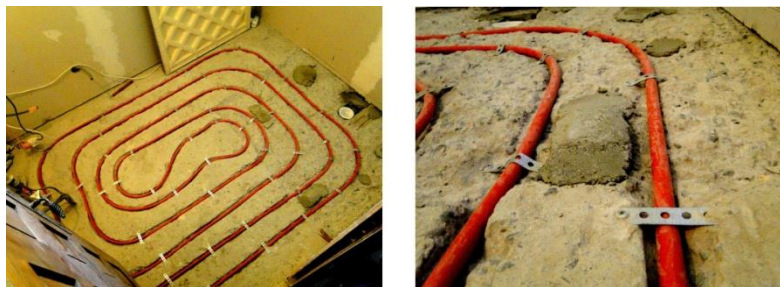
Figure 8 : plancher chauffant de la salle de bain.
